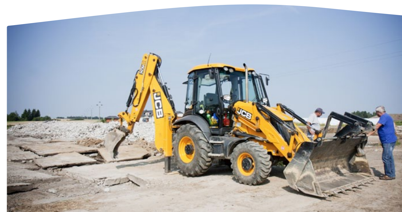
„Práce jde hned rychleji“, pochvaluje si pan Michalec při čištění plochy pro stavbu nového kravína.
